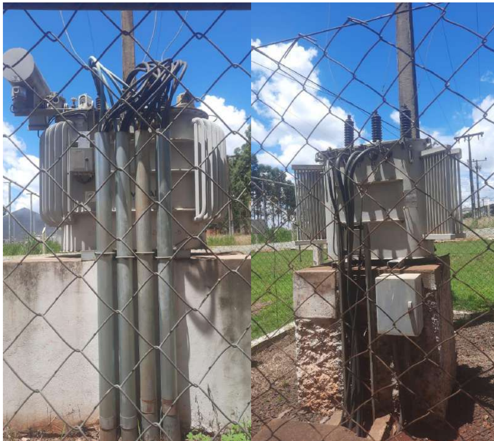
Figura 5: Transformadores de 500kVA e 300kVA, SE Fábrica de Ração.
