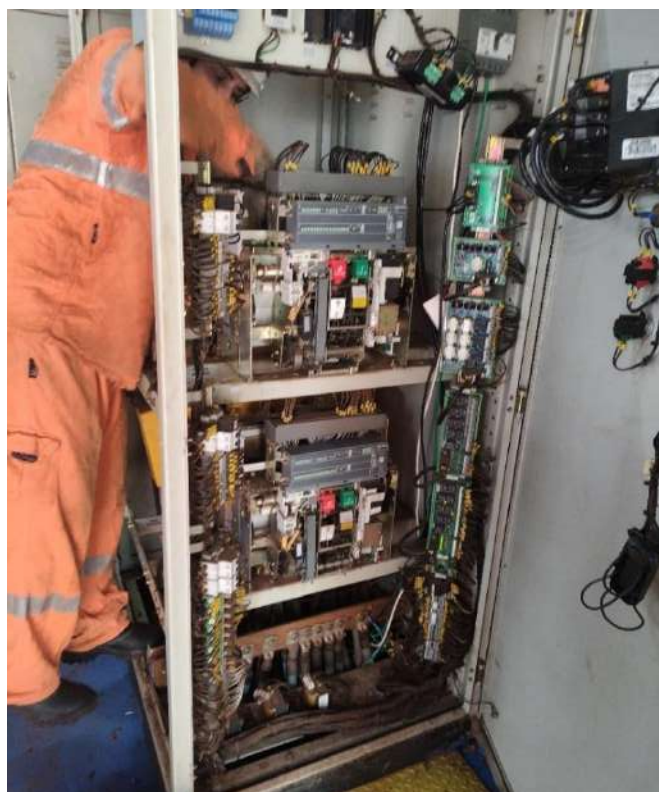
Figura 12: Painel gerador principal antes da intervenção.
