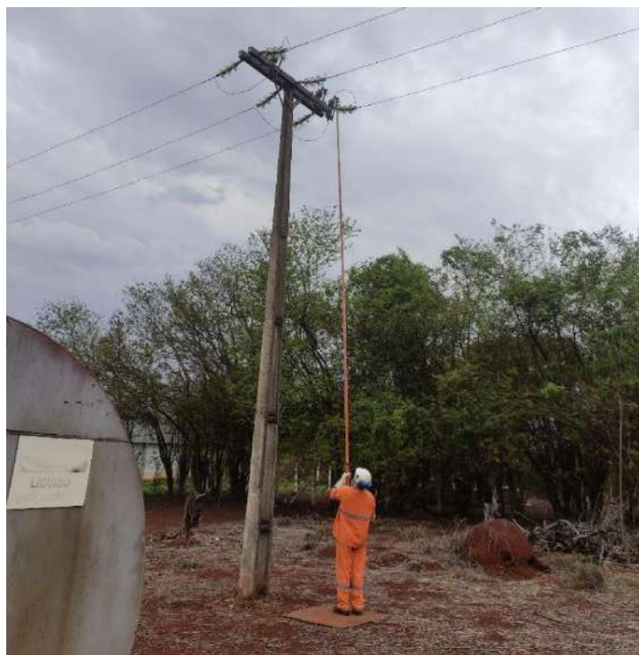
Figura 10: Abertura de chaves Fusíveis conforme NR10.
