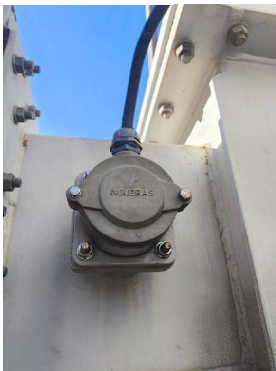
Figura 1: Detalhe do Sensor de temperatura com vazamento (TRAFO WEG).
