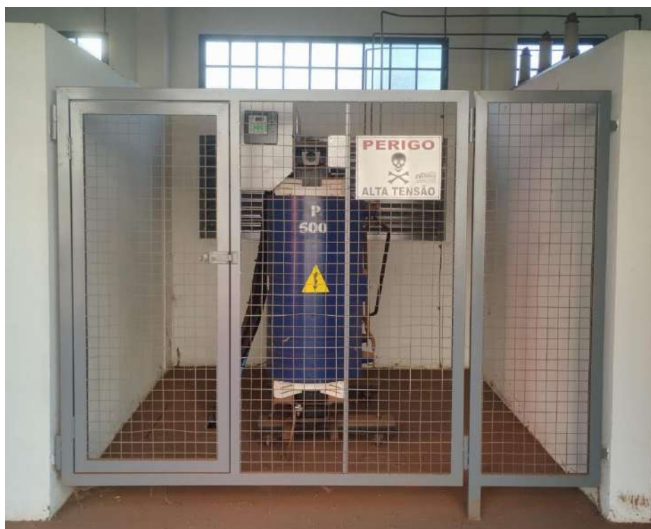
Figura 5: Transformador Elétrico de Potência 500 kVA, a seco.
