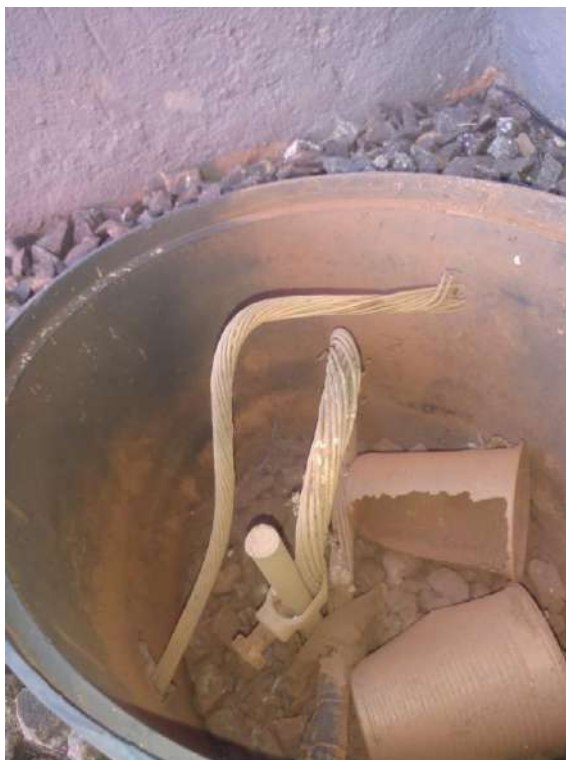
Figura 8: Cabo da malha de aterramento desconectado da haste (Não conformidade).
