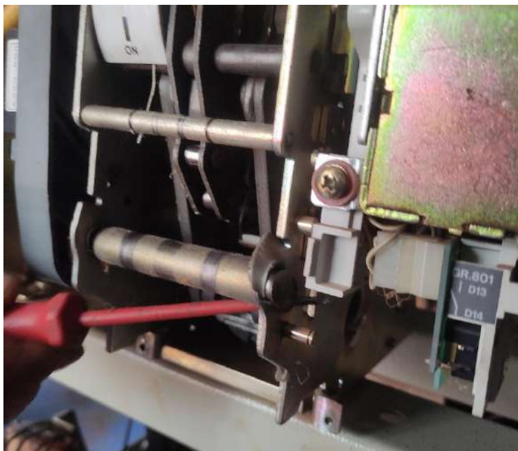
Figura 15: Manopla de tensionamento da mola do Disjuntor AG02055106 quebrada.
