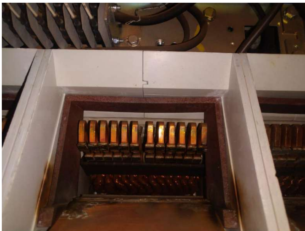
Figura 8: Contatos/ Câmara de extinção de arco – DJ Gerador Principal.
