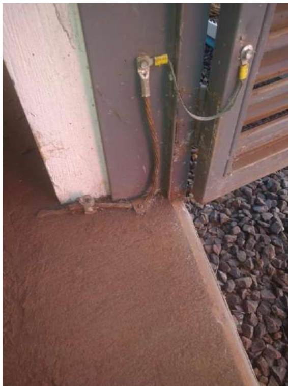
Figura 10: Aterramento das portas OK.
