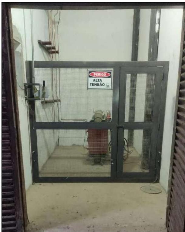
Figura 1: SE antes da limpeza e manutenção.
