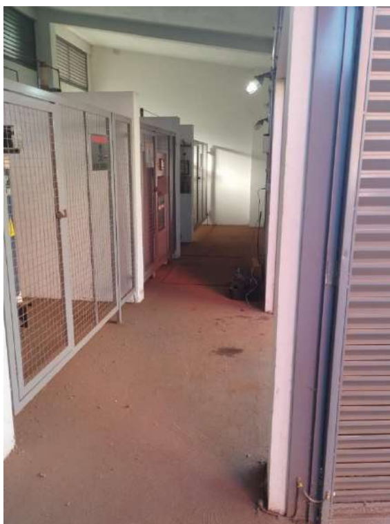
Figura 7: Corredor técnico (Área controlada - NR10 MTE).
