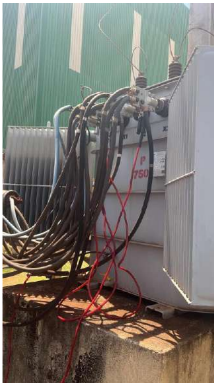
Figura 1: Aterramento temporário conectado (Conforme NR10).
