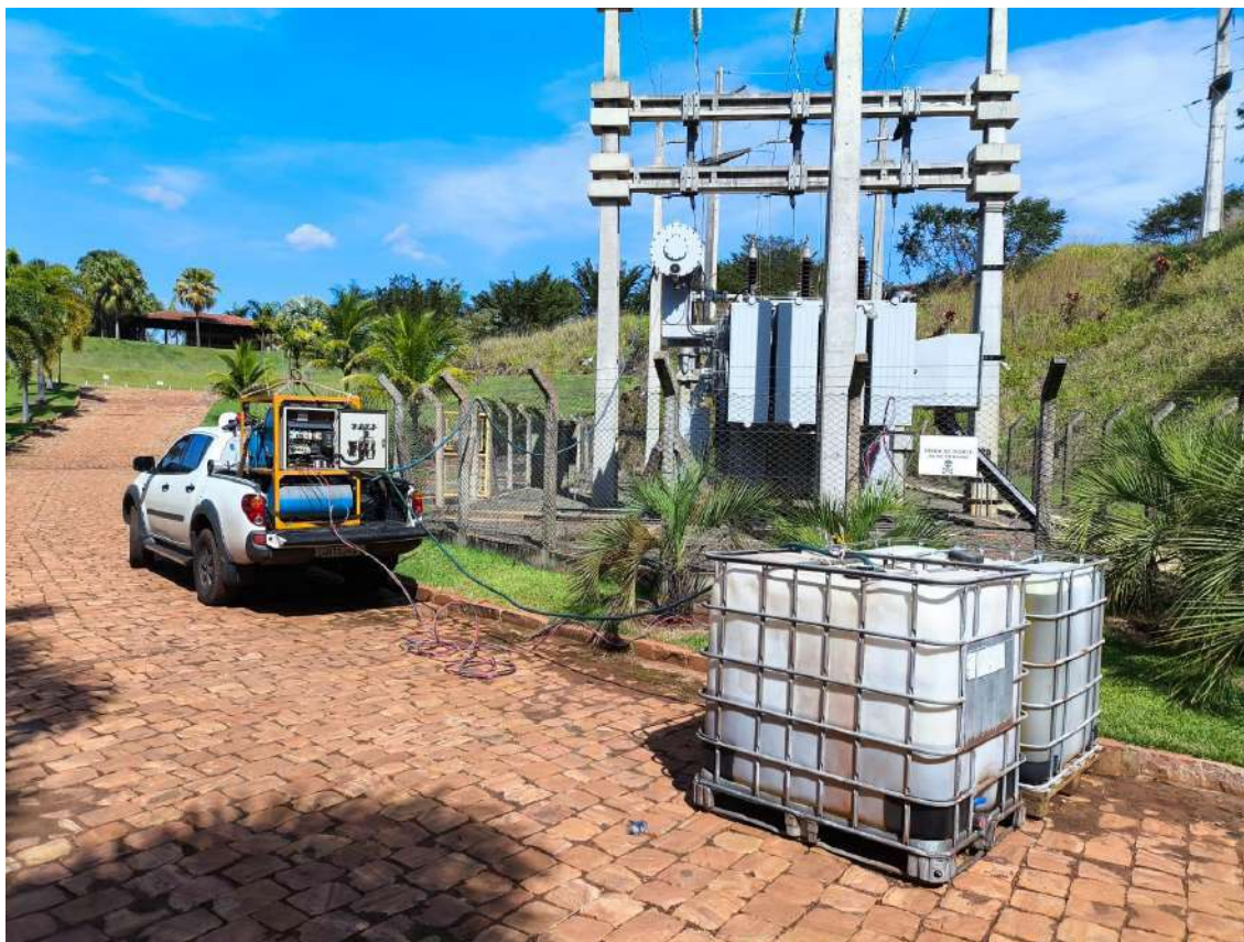
Figura 2: Termovácuo e reservatórios para retirada de óleo.
