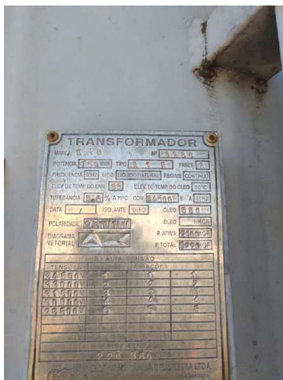
Figura 21: Placa transformador 750 kVA.
