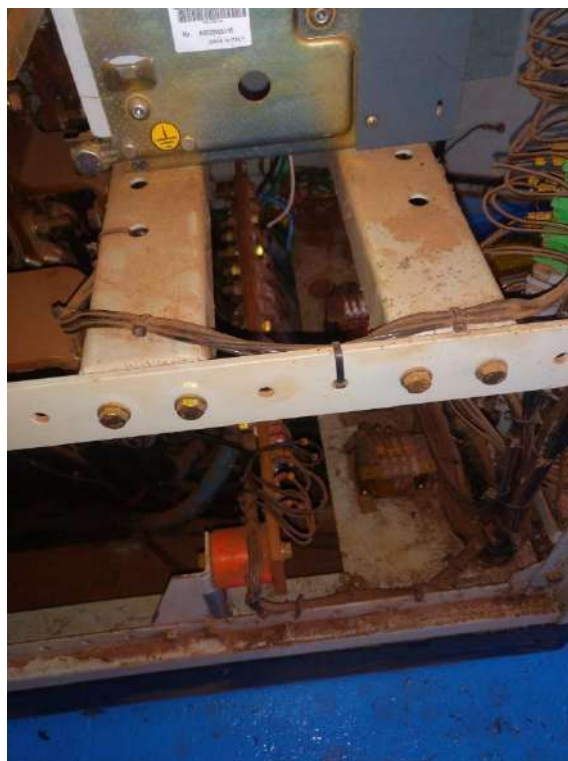
Figura 7: Painel gerador secundário antes da limpeza e manutenção.
