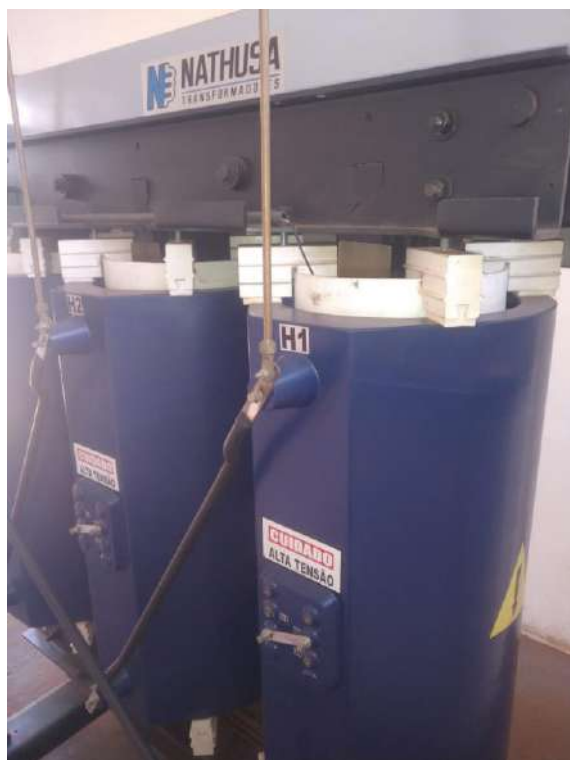
Figura 14: Transformador após limpeza e manutenção.
