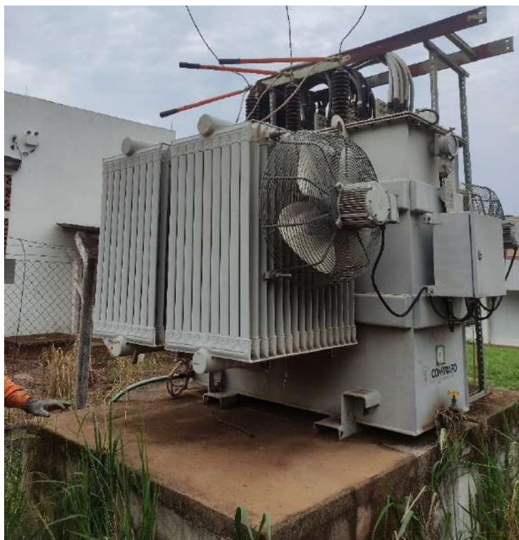
Figura 11: Aterramento temporário, conforme NR10.
