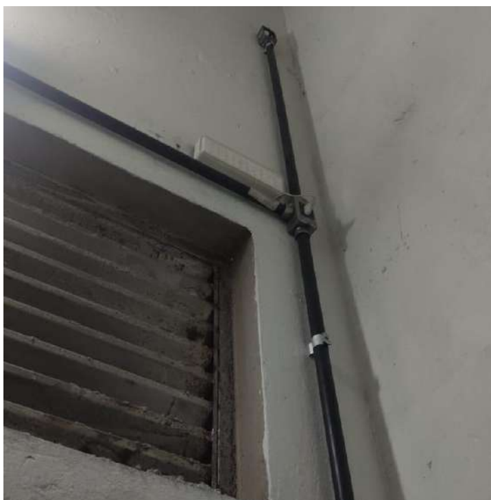
Figura 2: Iluminação de Emergência não funciona.
