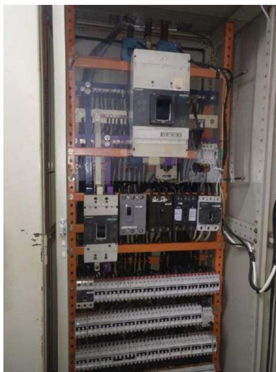
Figura 2: Disjuntor caixa moldada CCM antes da limpeza e manutenção.
