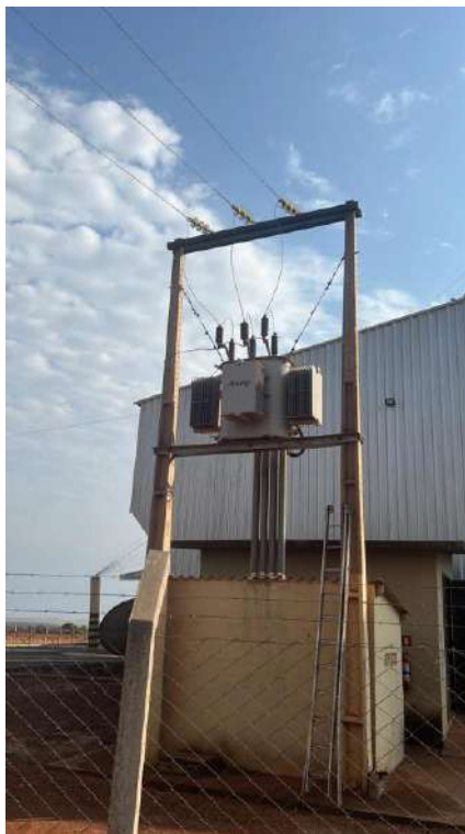
Figura 1: Transformador 500kVA em estrutura H.
