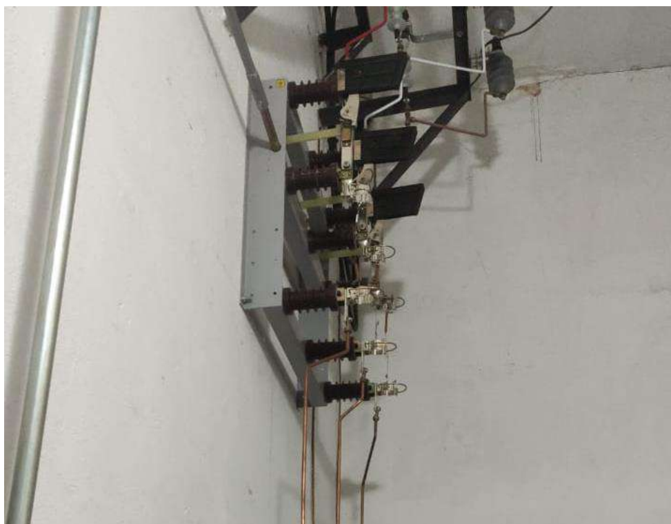
Figura 4: Ausência de fusíveis nas fases.
