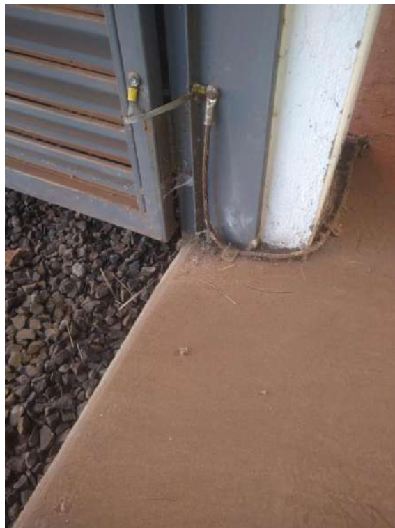
Figura 12: Aterramento das portas OK.
