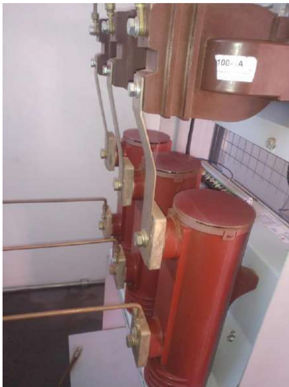
Figura 16: TC's após limpeza e manutenção.
