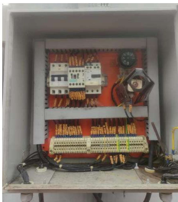
Figura 19: Painel de instrumentos auxiliares está desenergizado.
