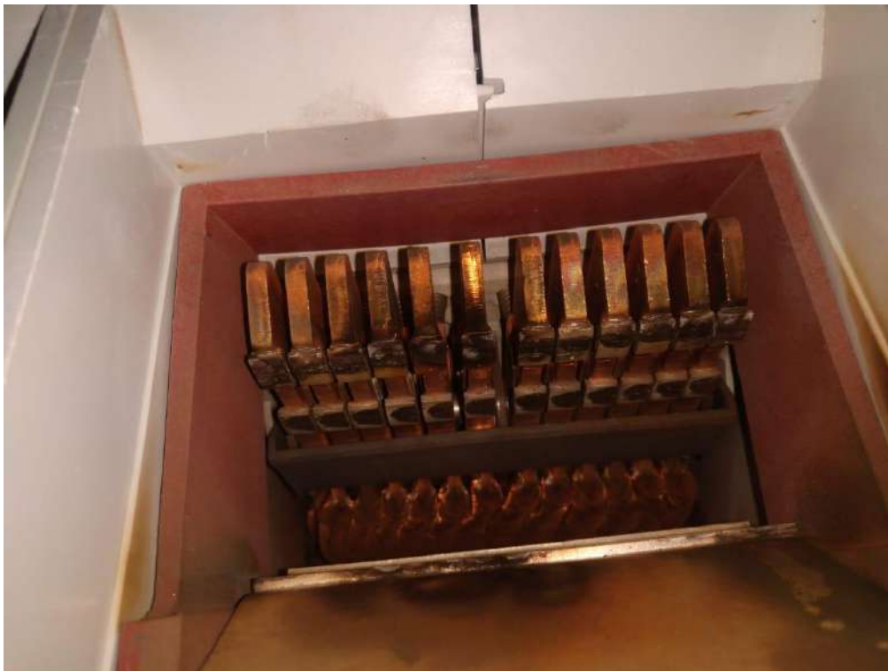
Figura 3: Disjuntor AG02055108 com sujeira nos contatos (Resistência > 300 uOHMs) .
