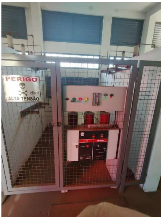
Figura 4: Disjuntor de média tensão.
