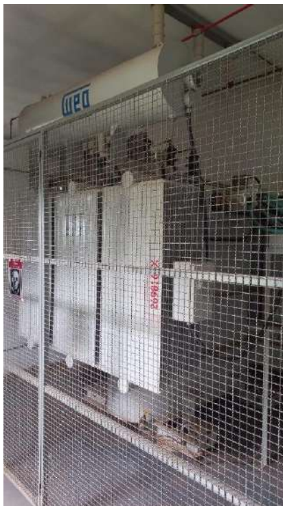
Figura 1: Transformador 2500 kVA, SE Entrada.
