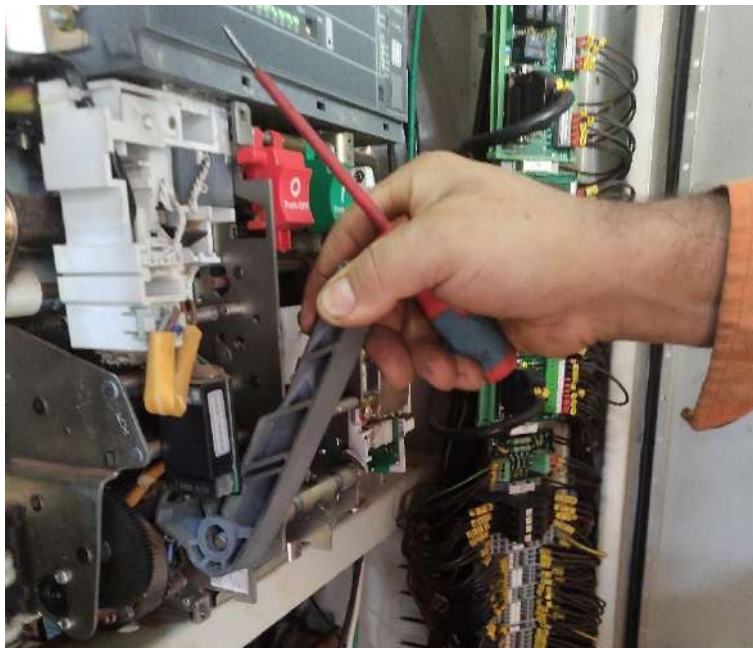
Figura 14: Manopla de tensionamento da mola do Disjuntor AG02055106 quebrada.
