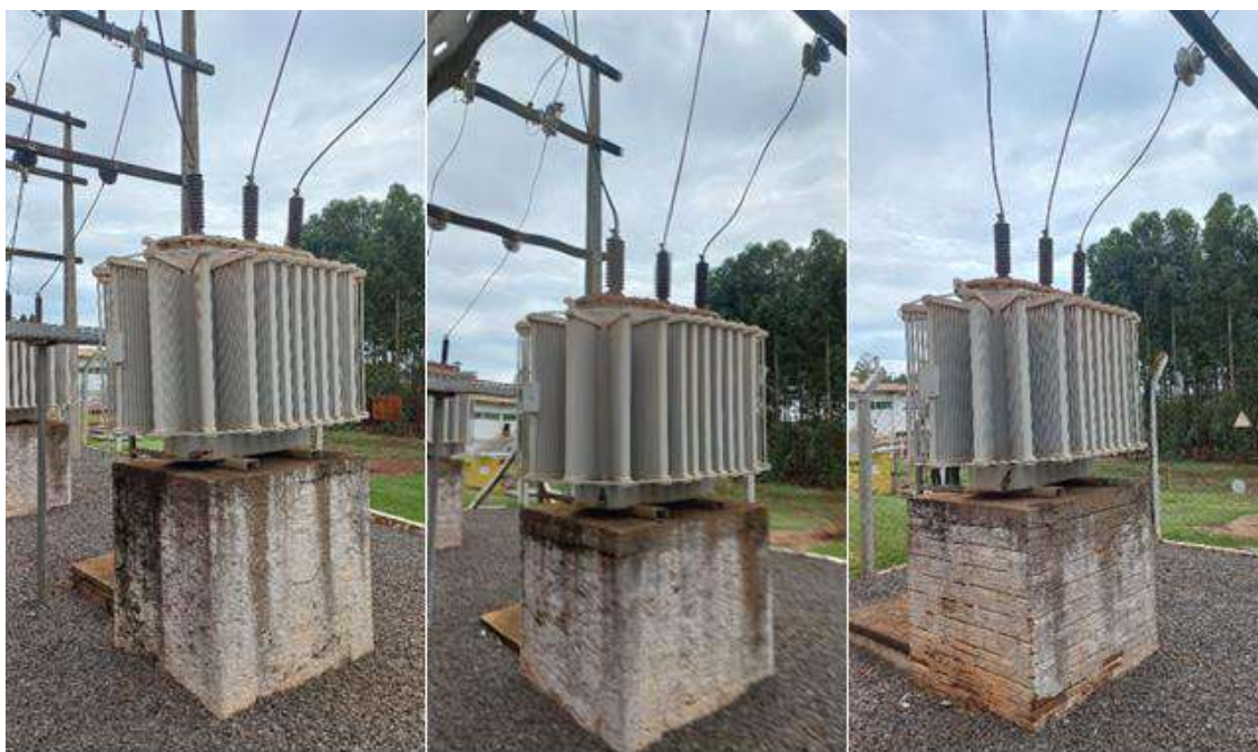
Figura 2: Transformadores 500kVA, SE GFA.
