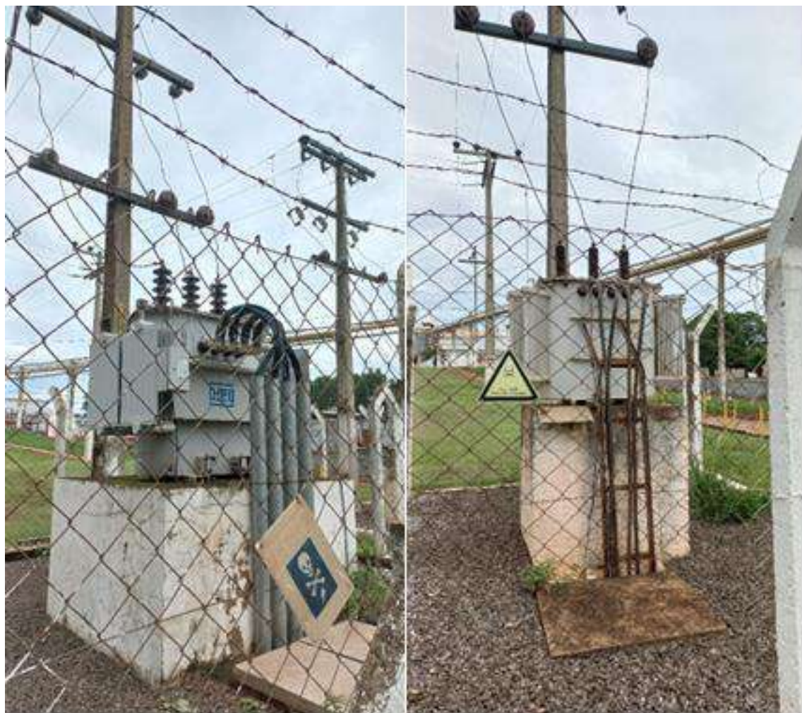
Figura 3: Transformadores 500kVA e 300kVA, FFG..
