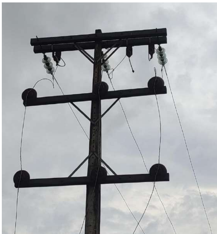
Figura 18: Para Raio da Fase S está aberto e o cabo desconectado com a malha. O transformador 1500 kVA está sem proteção contra descargas atmosféricas.
