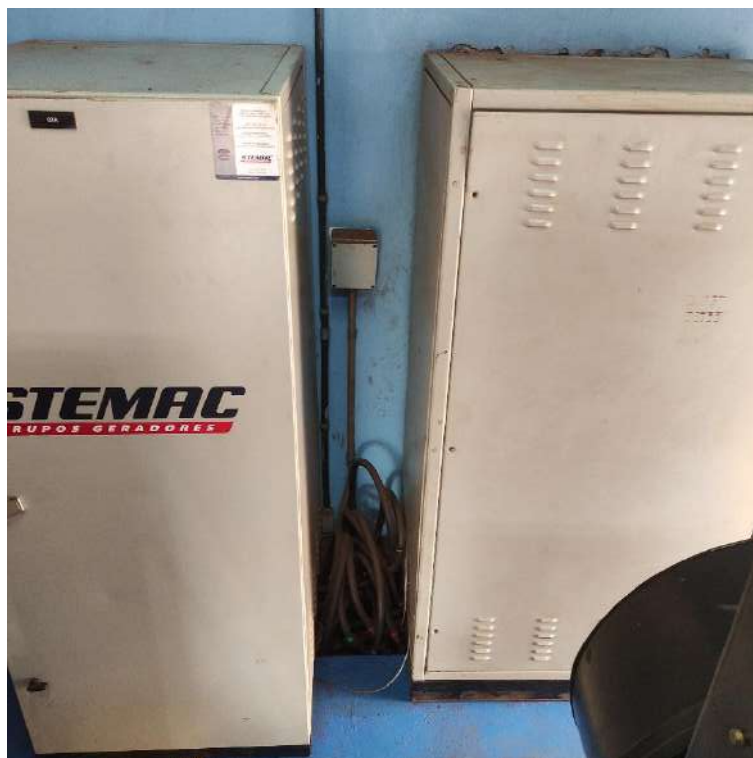
Figura 16: Painéis dos geradores após limpeza e manutenção.
