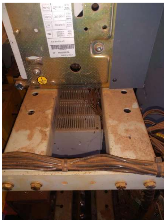
Figura 4: Painel gerador secundário antes da limpeza e manutenção.
