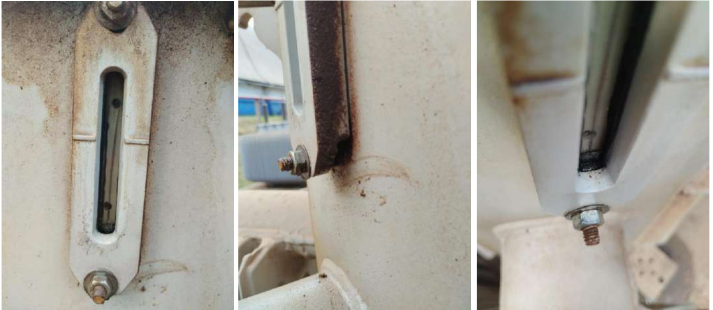
Figura 1: Visor de nível quebrado e vestígios de vazamento.
