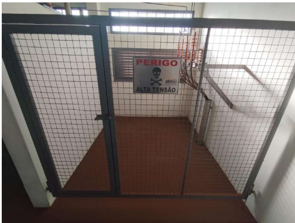
Figura 2: Entrada de tensão 13,8kV (Muflas, para-raios e barramentos).
