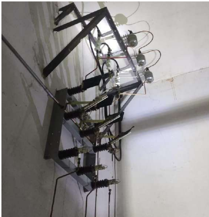
Figura 3: Muflas não conectadas ao aterramento.
