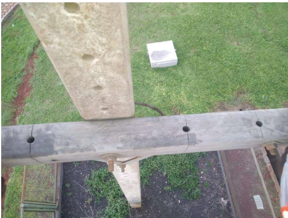
Figura 9: Cruzetas trincadas na estrutura do transformador.
