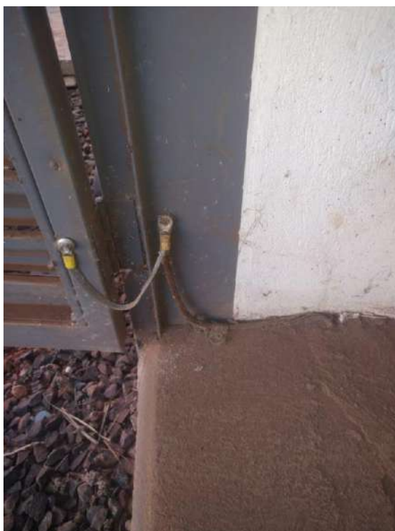
Figura 11: Aterramento das portas OK.
