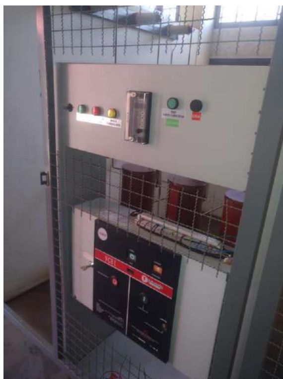
Figura 15: Disjuntor após limpeza e manutenção.
