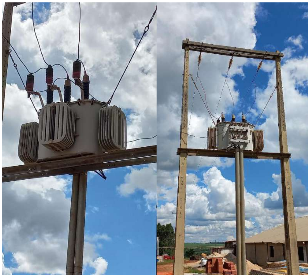
Figura 4: Transformador 225kVA em poste, SE Captação.
