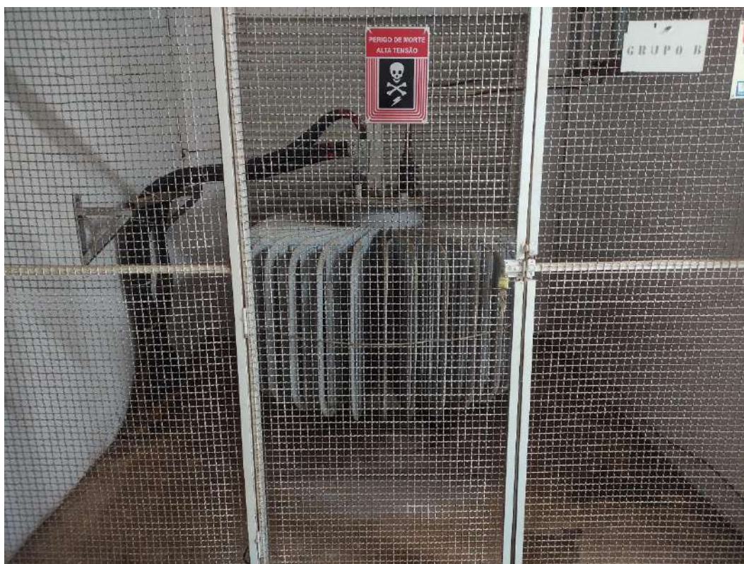
Figura 3: Transformador 750 kVA após manutenção preventiva.
