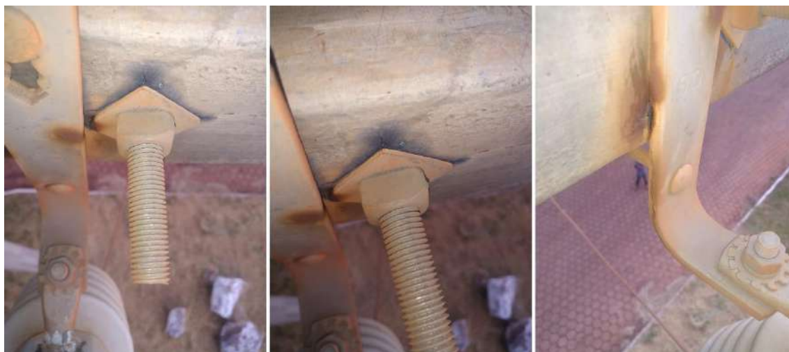
Figura 11: Fuga de Tensão encontrada na estrutura do Poste do Transformador.
