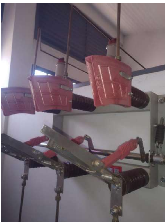
Figura 17: Chave seccionadora após limpeza e manutenção.
