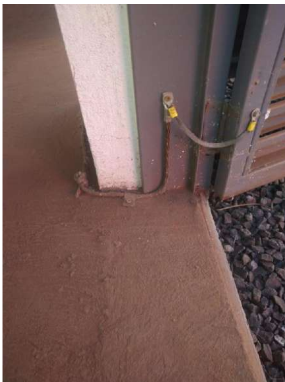
Figura 9: Aterramento das portas OK.
