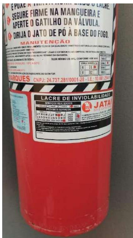
Figura 13: Extintor de incêndio vencido (Não Conformidade).
