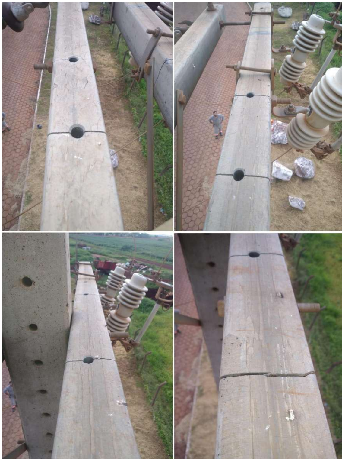
Figura 12: Cruzeta trincada em estrutura anterior ao transformador.
