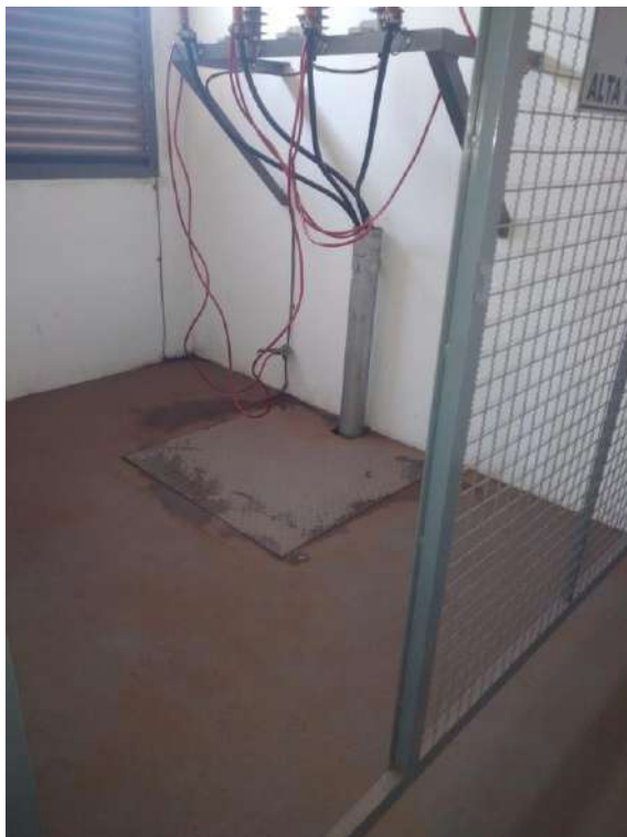
Figura 18: Entrada de tensão após limpeza e manutenção (Aterramento temporário OK).
