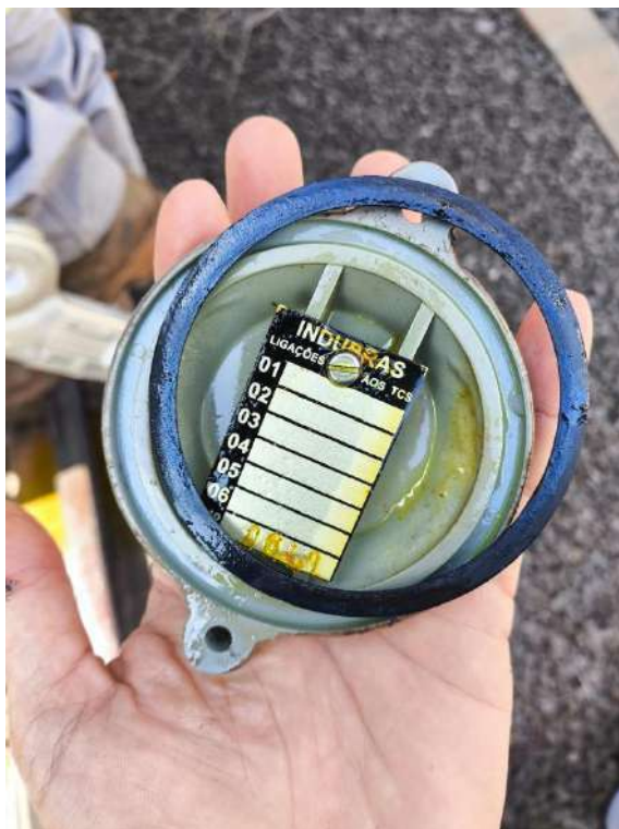
Figura 4: Vedações do sensor ressecadas e comprometidas.
