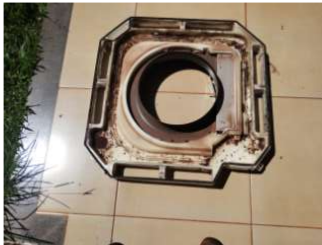
Calha de evaporadora
