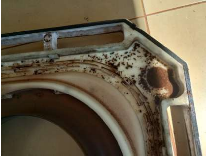
Calha de evaporadora
