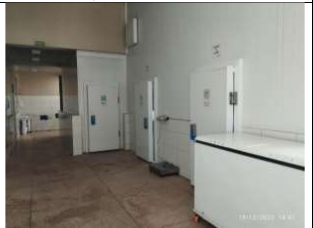
Figura 22 – Área câmara fria
