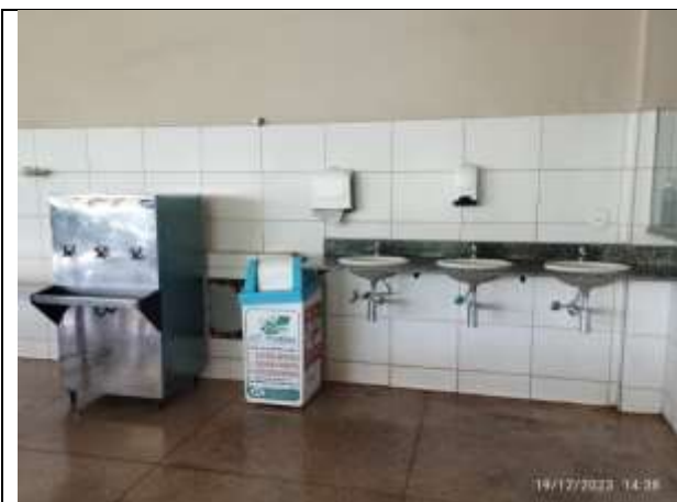
Figura 13 – Bebedor e lavatórios
