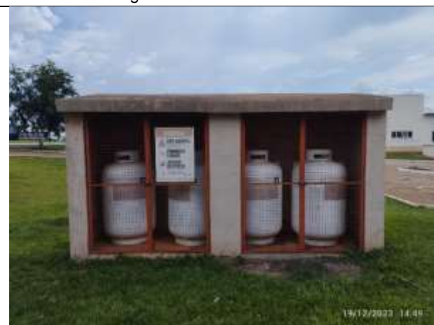
Figura 51 – Central de gás externa
