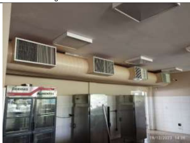
Figura 17 – Dutos de ar
