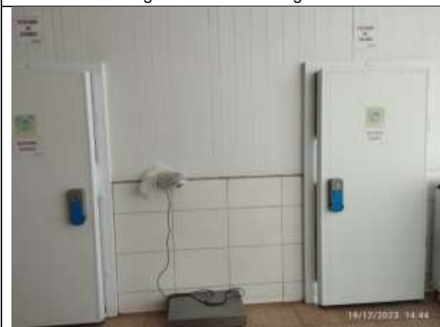
Figura 33 – Entrada câmara fria
