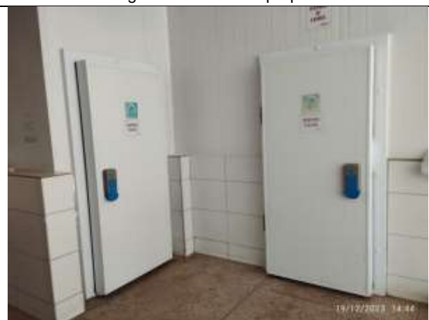
Figura 34 – Entrada Câmara fria
