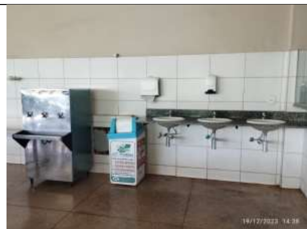
Figura 13 – Bebedor e lavatórios
