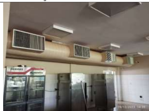
Figura 17 – Dutos de ar
