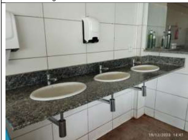
Figura 47 – Lavatórios área refeição
