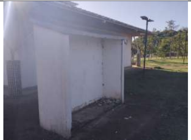
Figura 22 – Central de gás
