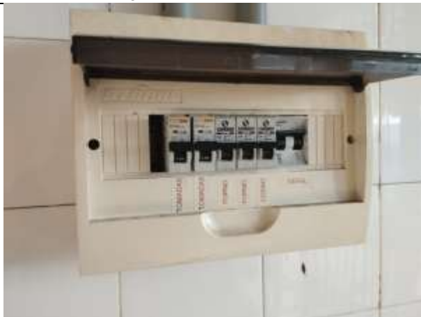
Figura 5 – Quadro de disjuntores interno
