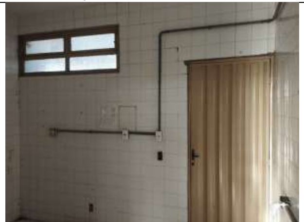
Figura 6 – Instalações elétricas cozinha
